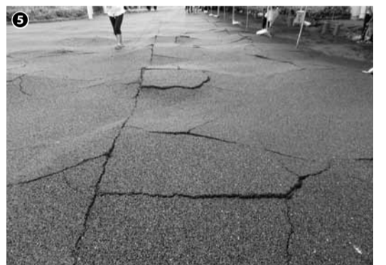
④1階部分が座屈した住宅⑤波打つ路面
